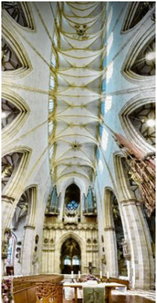
Der Putz am 42 Meter hohen Gewölbe bröckelt. Deshalb ist jetzt schnelles Handeln gefragt. Foto: Alexander Kaya
